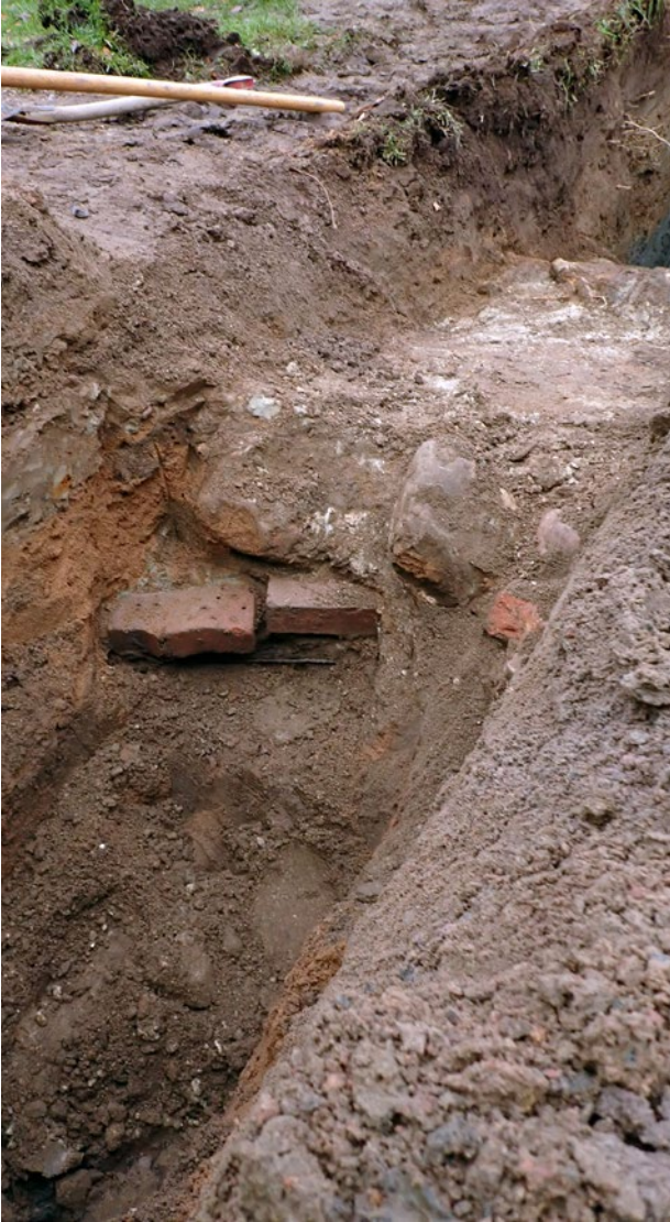
Figur 12. Foto av skalmuren nedanför Rotundan. Skadad av en äldre elkabel under tegelbrockor på dess södra sida (Fotonr: 2025-18-5). Mot norr. Foto: Johanna Olsson.
